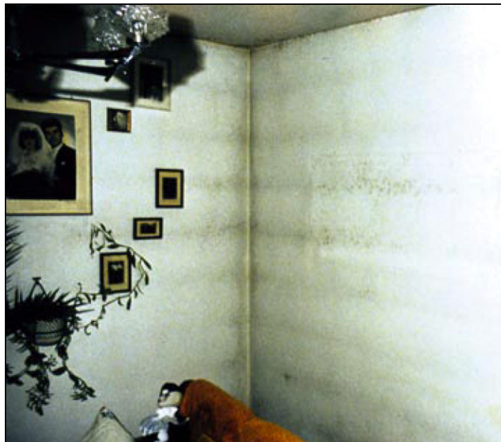
Abbildung 6: Phantomzeichnungen auf der inneren Oberfläche von Außenwänden
