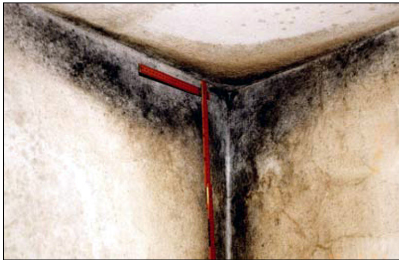
Abbildung 5: Schimmelbildung in einer Außenwanddecke
